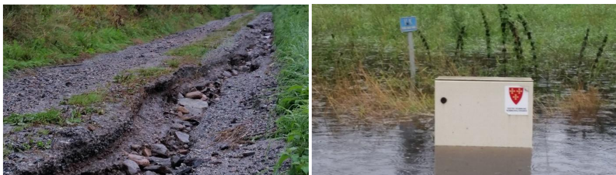
Figur 1. To eksempler på konsekvenser av ekstremregn i Akershus fylke i september 2019. Til venstre: Erosjonsskade på grusvei forårsaket av kraftig overflateavrenning, som viser hvordan ukontrollert overvann kan skade infrastruktur. Til høyre: Et el-skap delvis under vann, som illustrerer hvordan kritisk infrastruktur kan bli utsatt når overvannsforhold ikke fanges opp i planer, kart eller forvaltningssystemer. Foto: Tom Joar Kristiansen.
